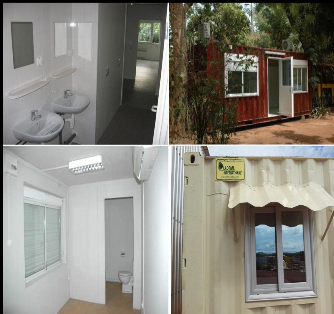
Vue interieur de containers aménagés en salle d'eau et en toilette.
